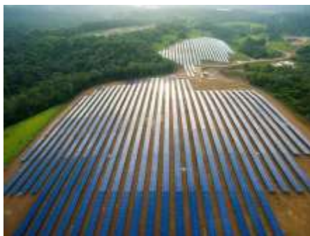
Figura 13 – Usina Solar Oiapoque I
