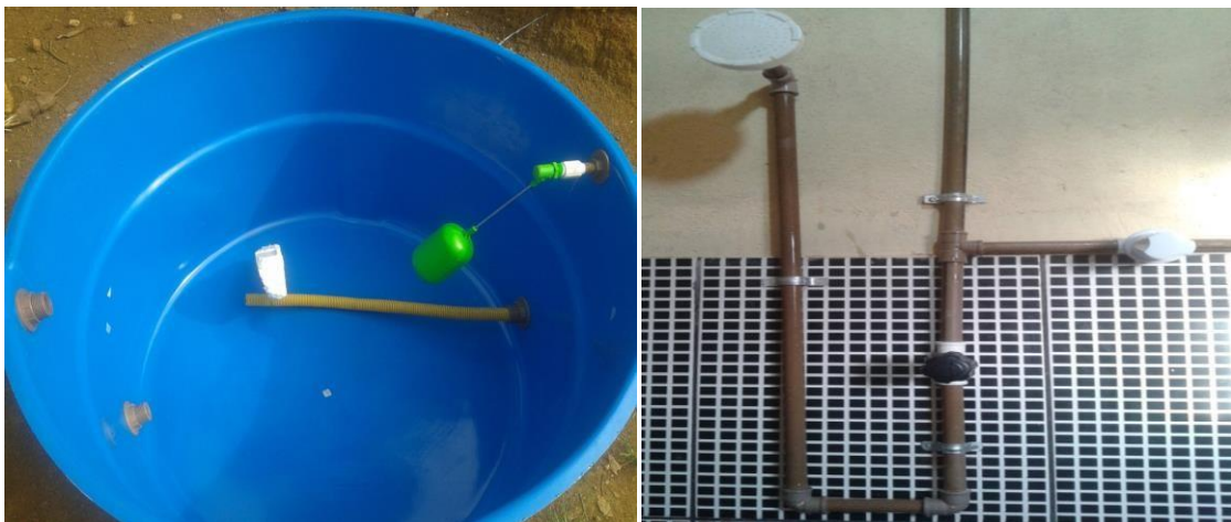
Figura 5 – Instalações na caixa d'água e no banheiro da resid. Fonte: Os autores.
